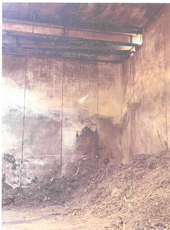
dettaglio angolo punto dell'incendio
